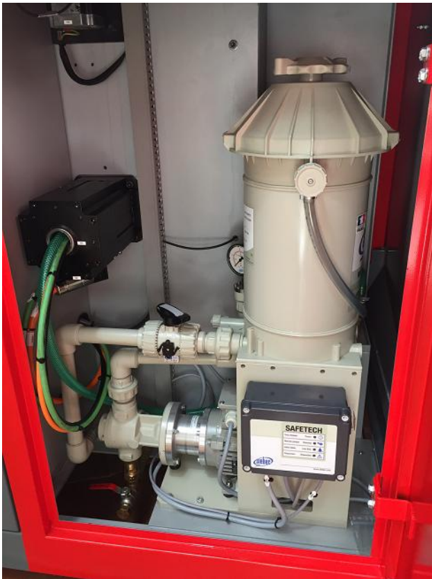
Sistema de filtragem de cartucho Siebec
